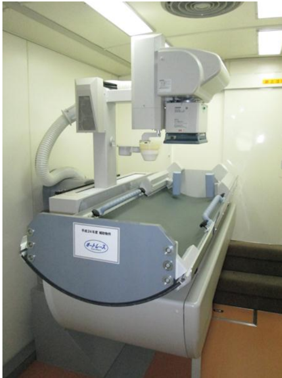
< X線発生装置・透視撮影台 >
